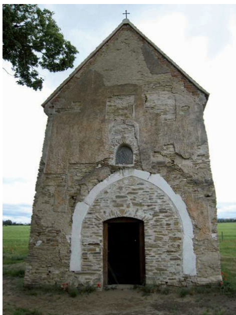
Obr. 25.: Kopčany, kostolík sv. Margity, pohľad na západné priečelie. Stav po znížení nivelety, zamurovaní srtedovekého portálu a barokového okna. Zrekonštruované primárne okno a vstup s nevhodným segmentovým ukončením (Foto : A. Botek).
